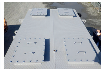
① 上蓋取付状況
