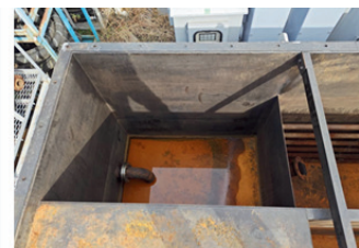
① 浮上油回収槽
