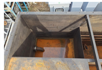
① 浮上油回収槽
